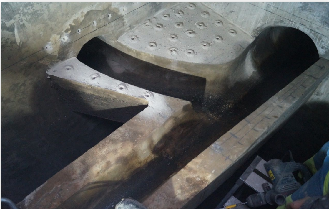
Abbildung 2: Zu verschliessende Meteor - Durchlaufsohle in Kombischacht
