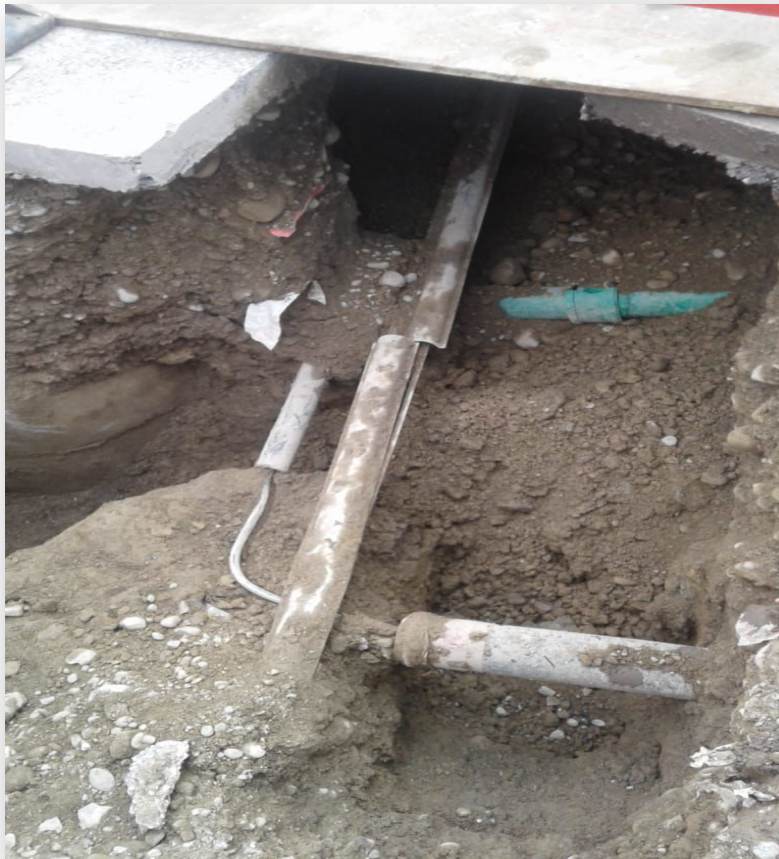
Abbildung 1: Bestehende Situation: Neben verschiedenen Werkleitungen im Boden gestaltet sich die Positionierung eines zweiten Schachts aus Platzgründen schwierig.
